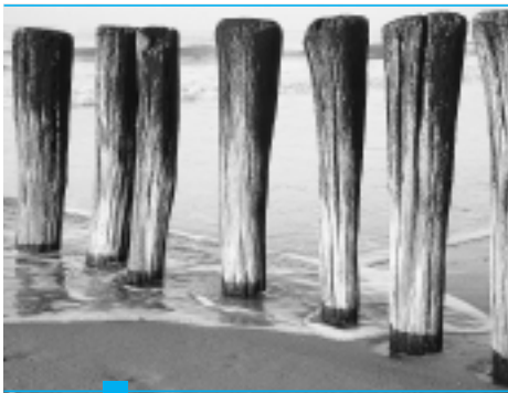
WWK Strandhoofden in de vorm van palenrijen zijn aan onze kust heel ongewoon, maar niet zo in delen van Nederland
